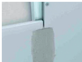
Fuga di 5-9 mm da stuccare
