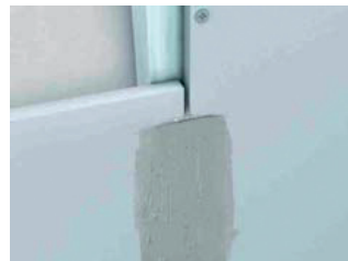
Fuga di 5-9 mm da stuccare
